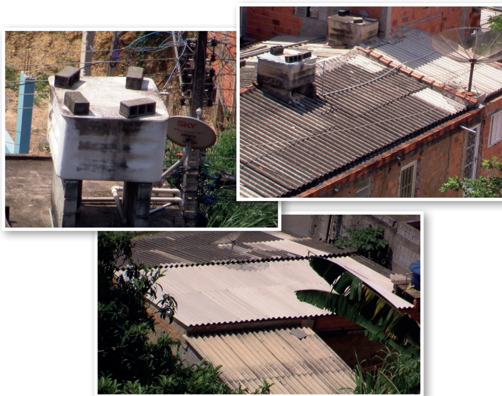
Figura 4 – Telhas de fibrocimento e caixas d'água encontradas nas edificações
